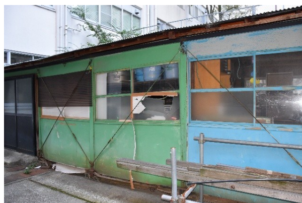
老朽化が進んだ課外活動団体関連施設
